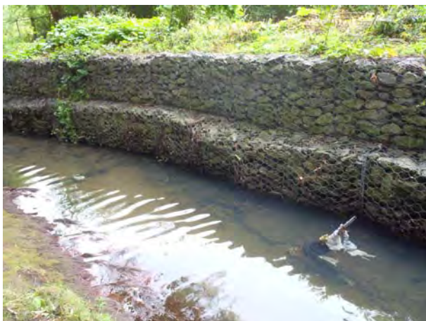
Erosion Site 1 Photo 5.JPG
