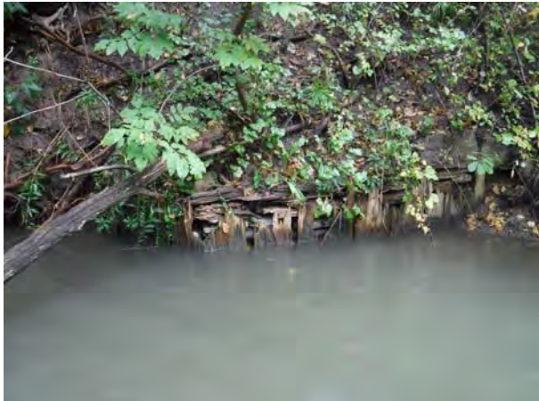
Erosion Site 3 Photo 3.JPG
