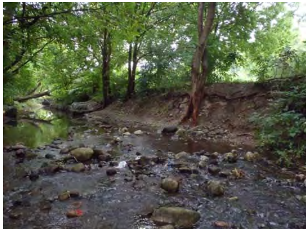
Erosion Site 1 Photo 4.JPG
