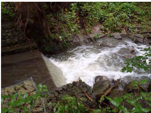
Erosion Site 3 Photo 5.JPG
