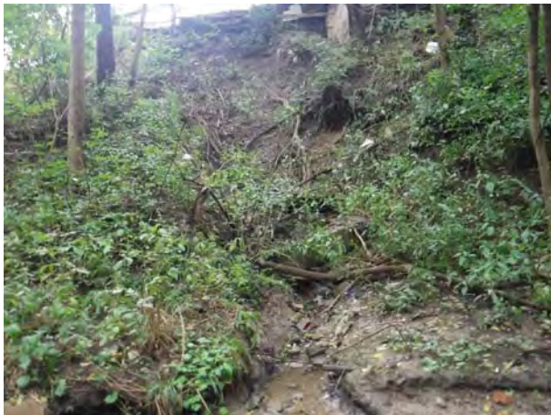
Erosion Site 2 Photo 3.JPG
