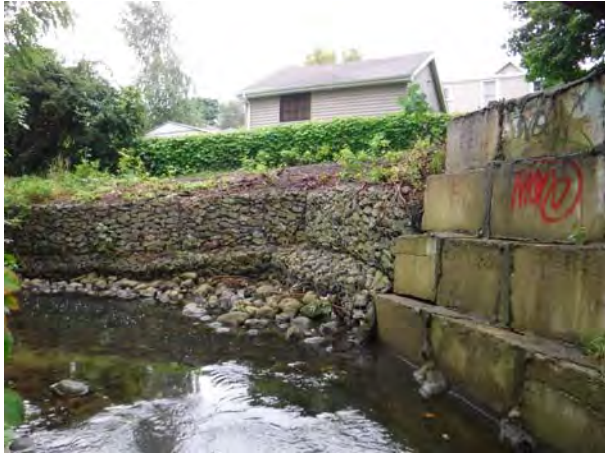
Erosion Site 1 Photo 1.JPG
