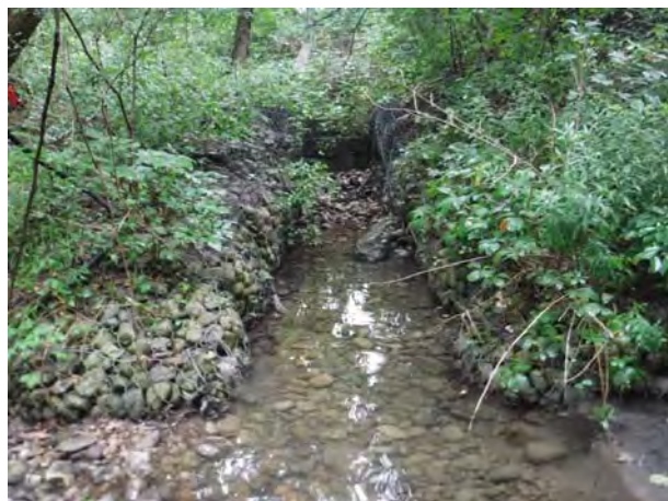
Erosion Site 2 Photo 6.JPG
