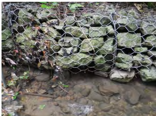
Erosion Site 1 Photo 6.JPG
